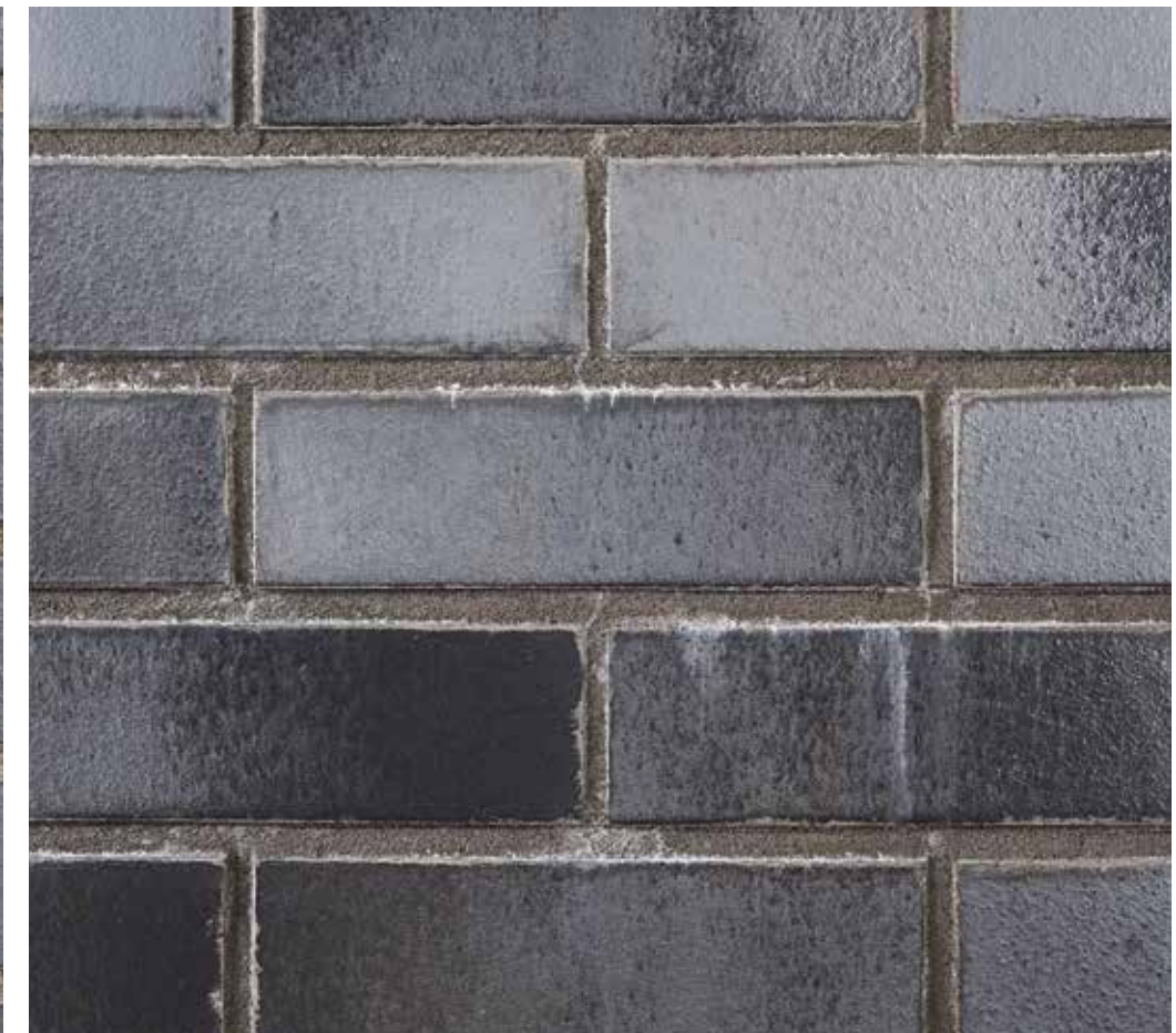
Auslaugungen an einem herkömmlichen Fugenmörtel
